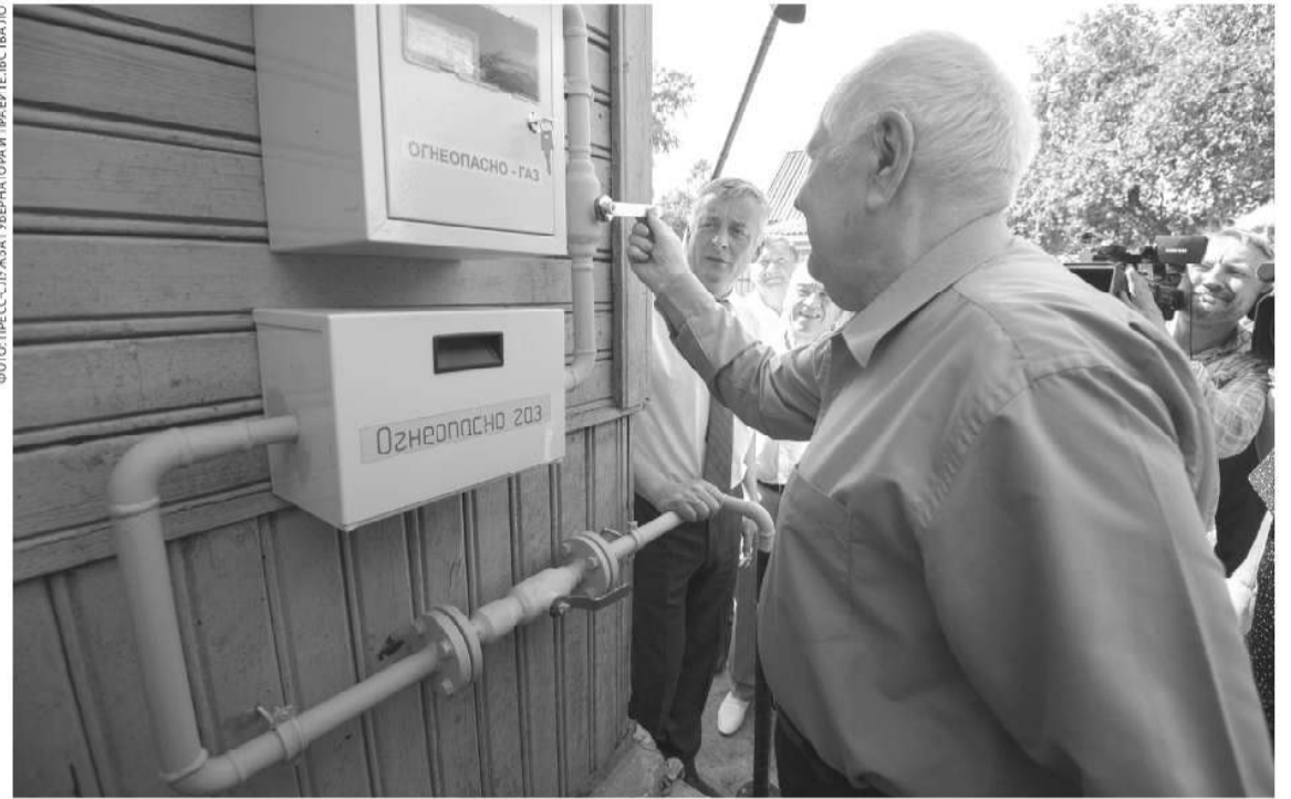
Область субсидирует расходы на проведение работ по догазификации в границах земельного участка
